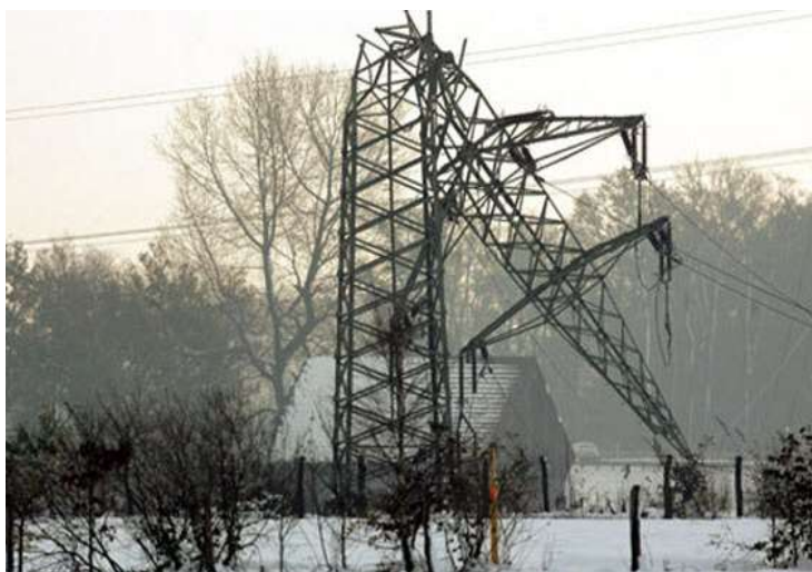
Рис. 6.4. Авария на ЛЭП в результате стихийного бедствия, приводящая к долговременным перерывам электроснабжения
